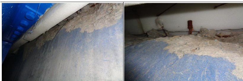
③ 교대 A1 파손 및 철근노출 - 진전여부 확인
